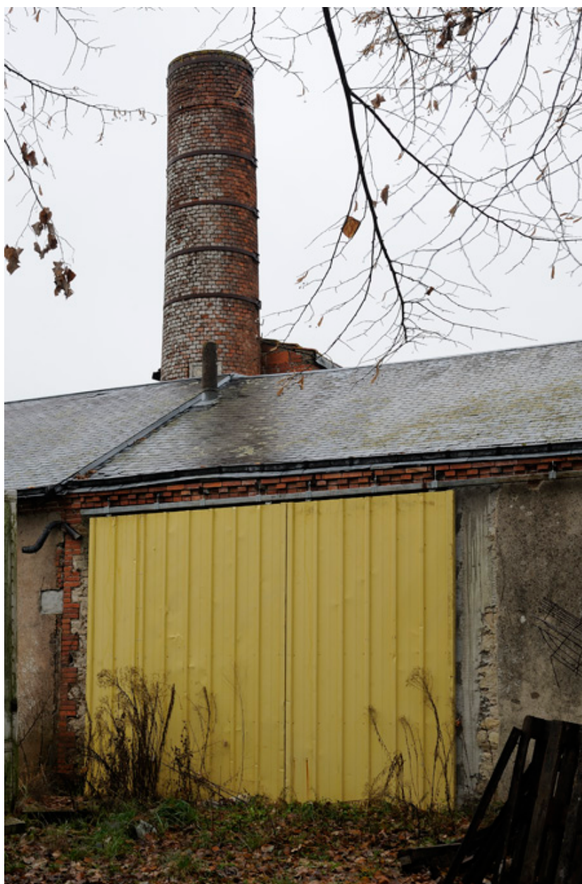
La cheminée en partie écroulée.
