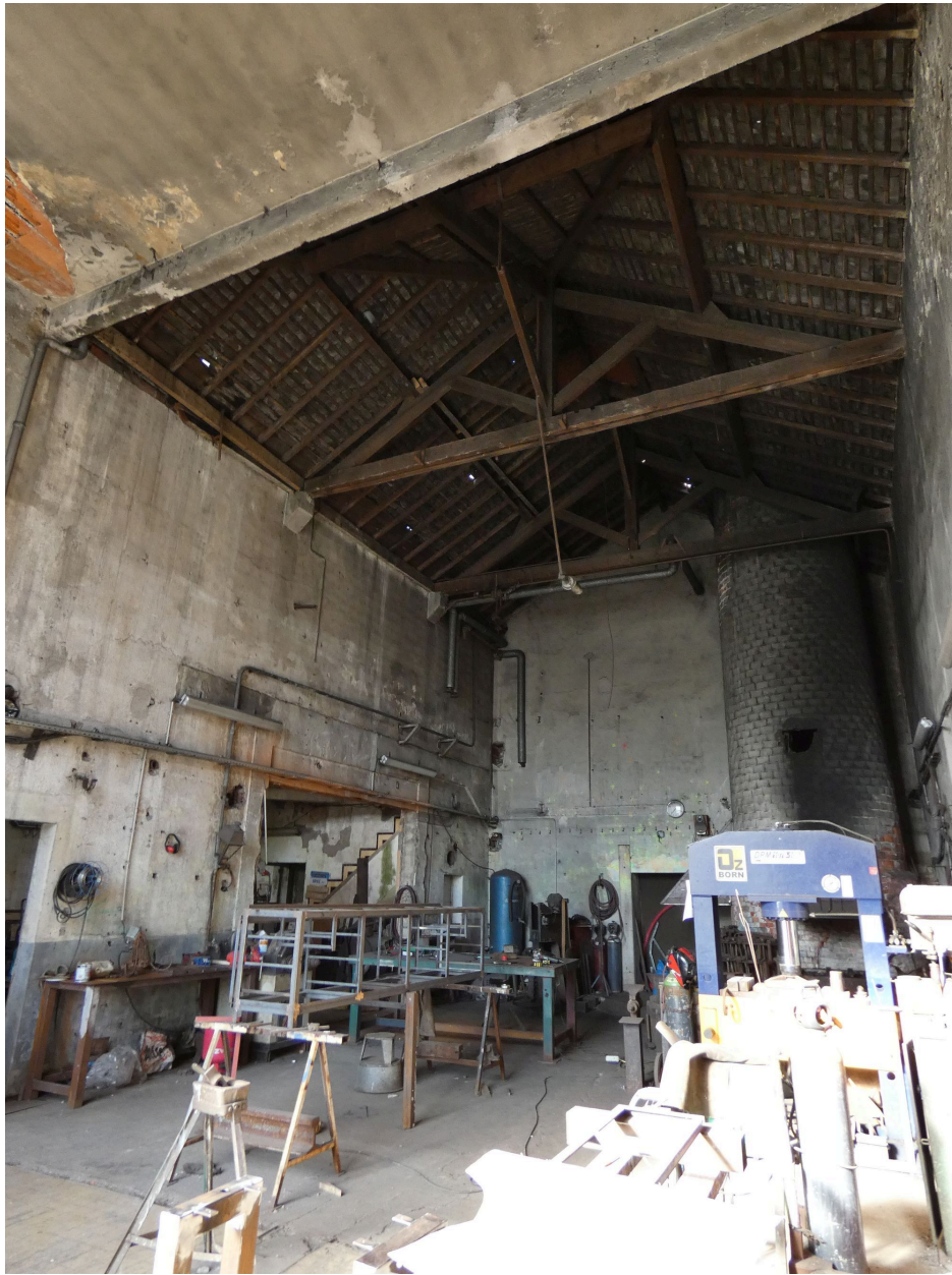
La chaufferie dans la partie est du corps principal de bâtiment nord, vue depuis l'est.
