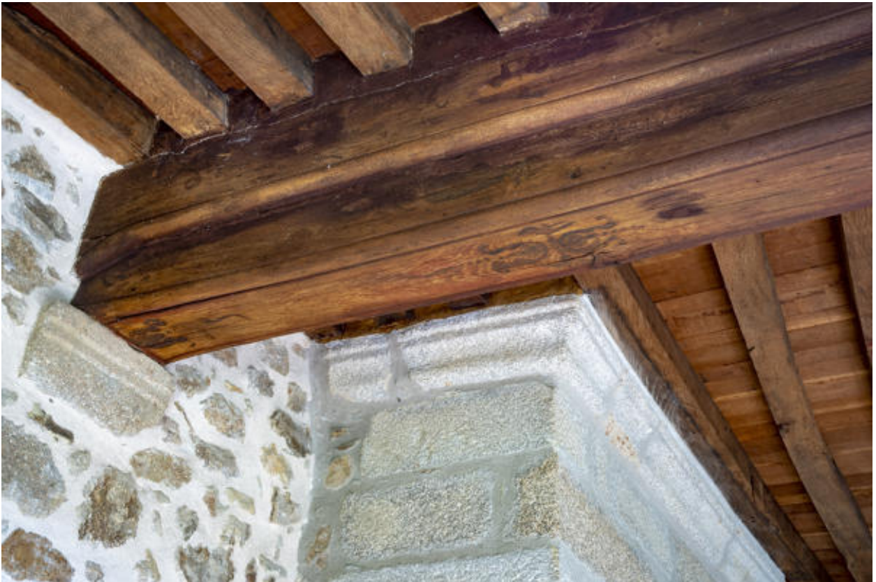
Un détail d'une poutre avec traces de peinture à l'étage du pavillon.
