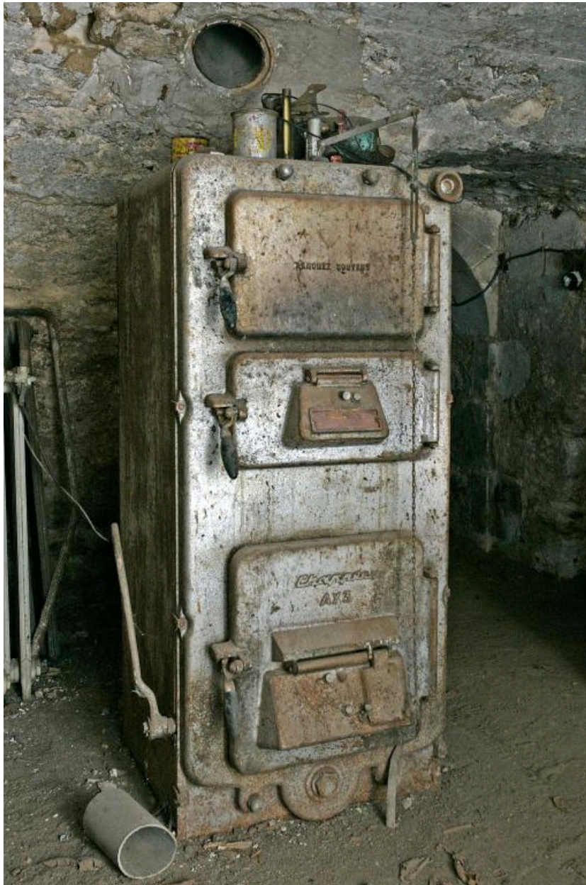
Le pavillon, sous-sol, chaudière, 2007.
