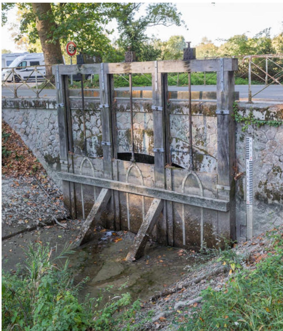
Vanne triple de régulation hydraulique dit du "canal d'irrigation".
