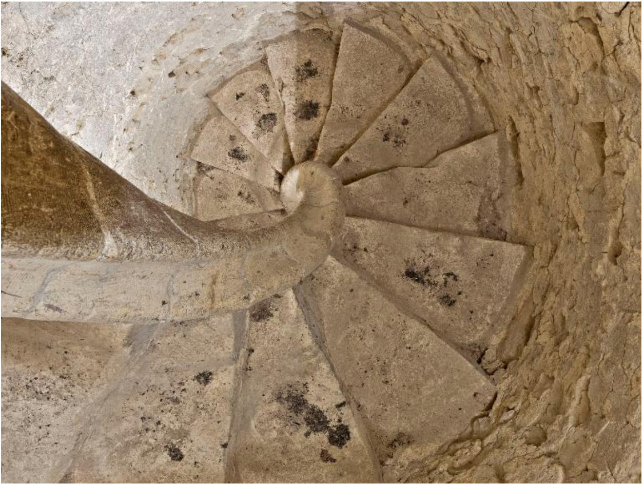
L'escalier à vis suspendu de la tour-clocher, réalisé en 1624 par Jehan Viet
