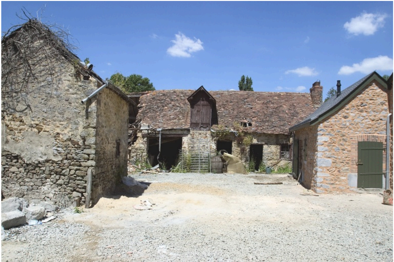
Vue d'ensemble depuis la cour au sud : la resserre, les anciens logis, la porcherie (?).
