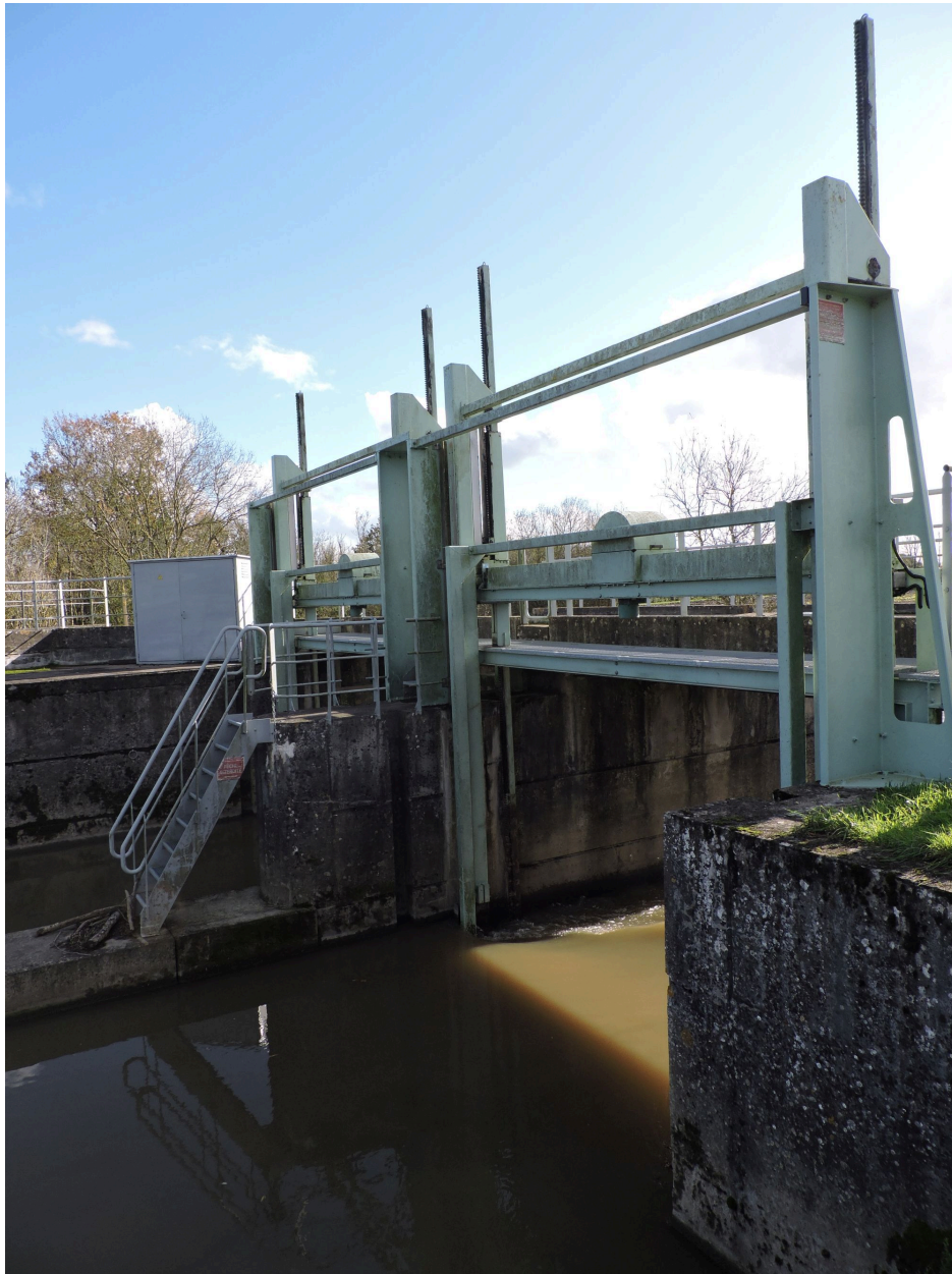
Le barrage au-dessus du second aqueduc, vu depuis le nord-ouest, en amont.
