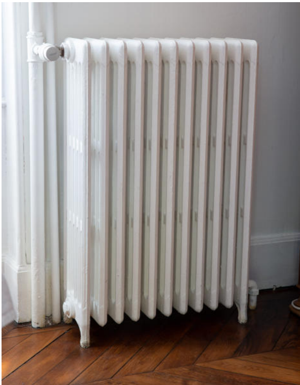
Vue d'un radiateur en fonte en rez-de-chaussée de la maison.
