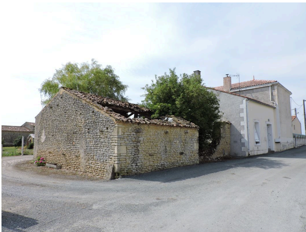
Le logis et les dépendances en ruines qui lui sont adossées, vus depuis le nord.
