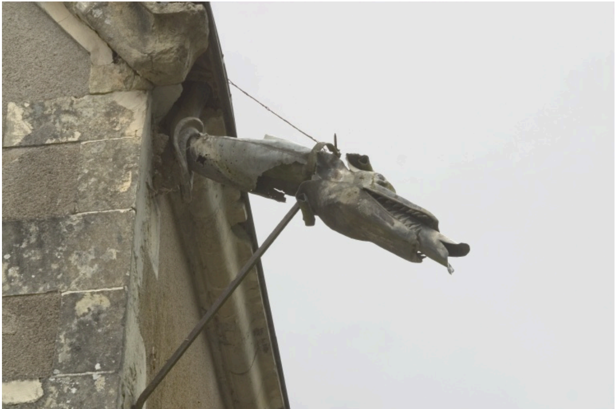
Chapelle : gargouille sud du mur est.
