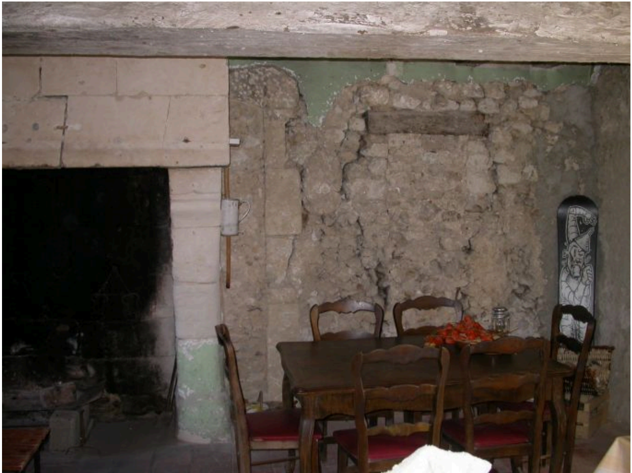
Rez-de-chaussée surélevé, salle sud : traces de remaniements (porte ?).
