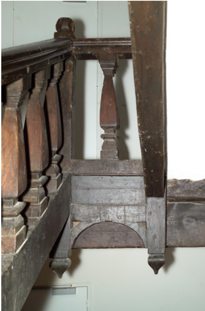
Détail des balustres et des poinçons de l'escalier en bois du bâtiment est.
