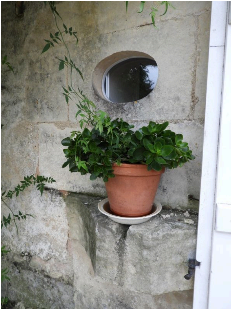
Pierre d'évier à côté de la porte de la maison côté jardin.
