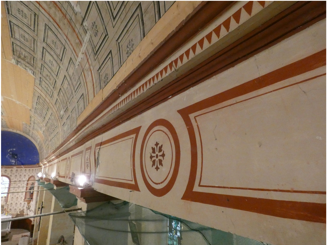
Entablement et corniche à la retombée de la fausse voûte de la nef.
