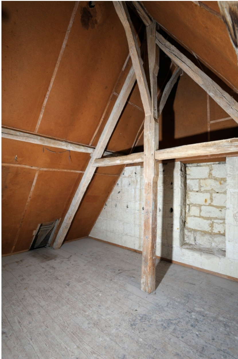
Ancienne chapelle nord (fin XVe siècle), comble. Charpente d'origine, à fermes et à pannes.
