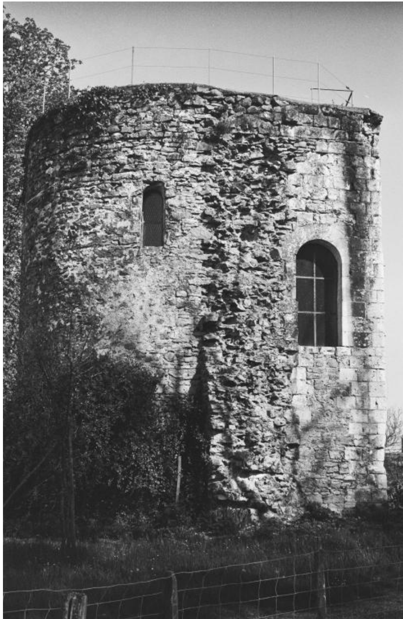
Détail de l'arrachement de la courtine.
