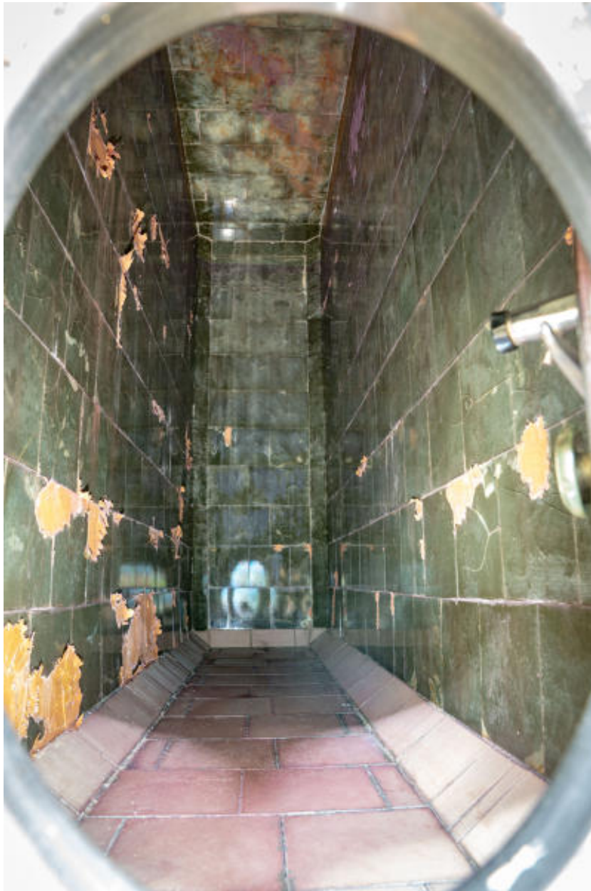
Intérieur d'une cuve aérienne verrée.
