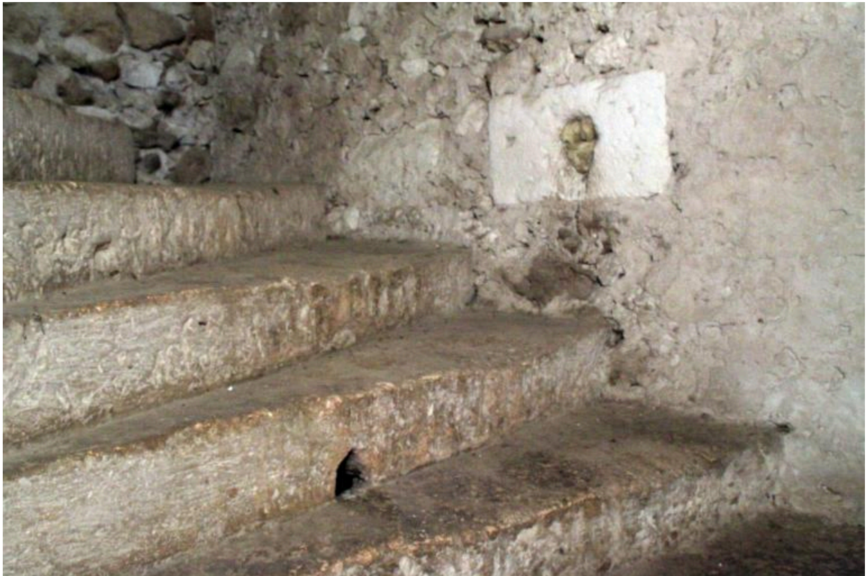
Tourelle d'escalier, rez-de-chaussée : bouche à feu et trou de visée dans la marche.
