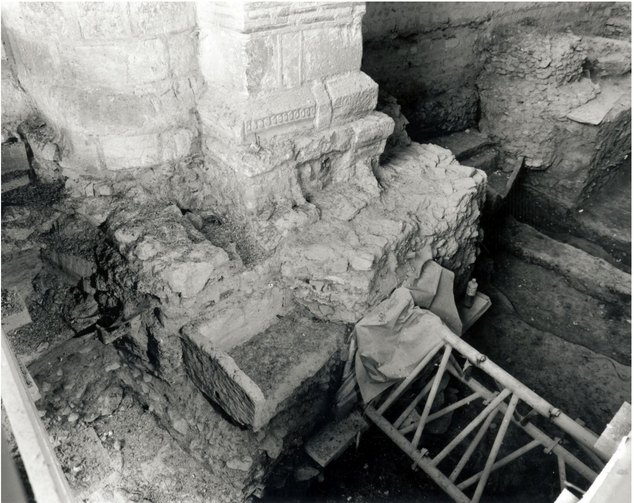
Collégiale Saint-Martin, croisée du transept, pilier nord de l'arcade côté chœur : base.
