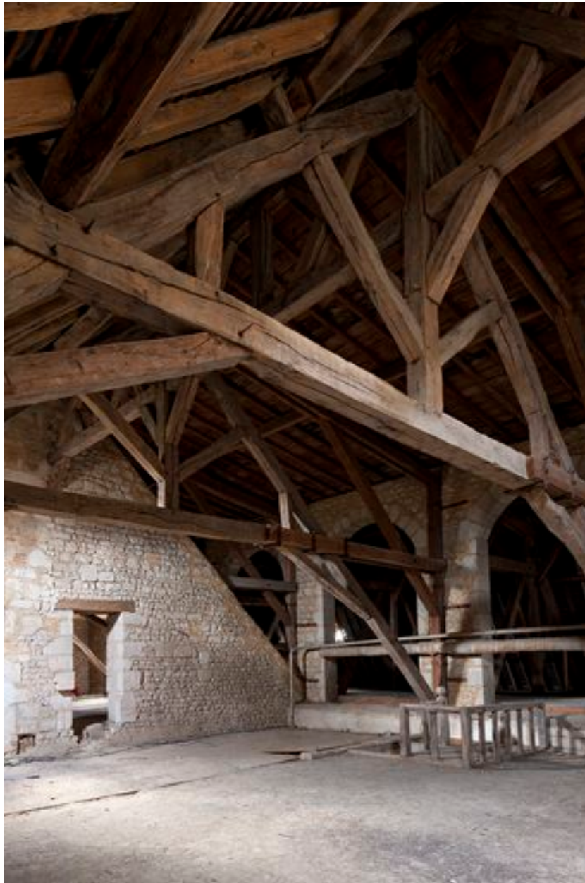
Charpente du bâtiment est. Vue prise de la partie située au-dessus de la salle du Conseil.
