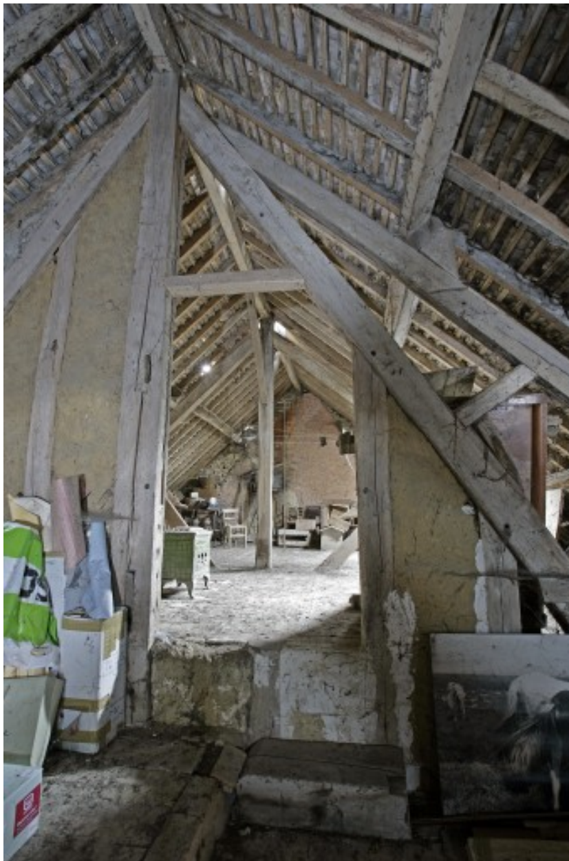
Partie supérieure de la ferme de charpente du corps principal du logis.
