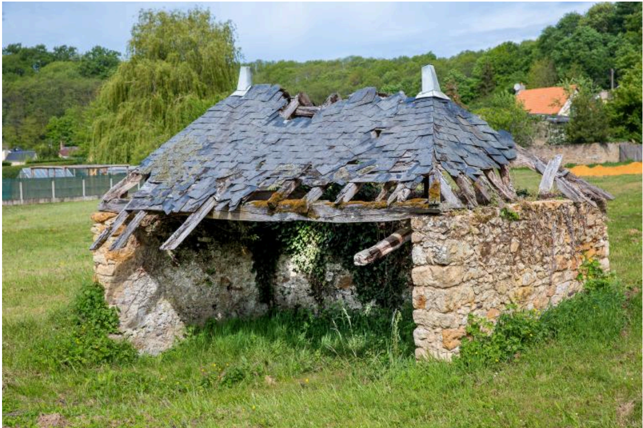
Le lavoir en ruine derrière la résidence de la Petite Vallée.
