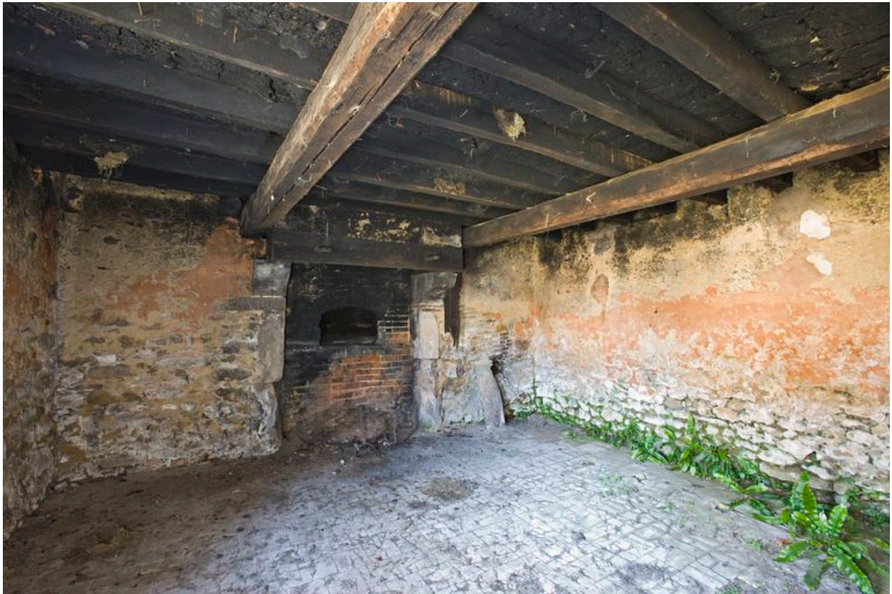
Vue intérieure du fournil.
