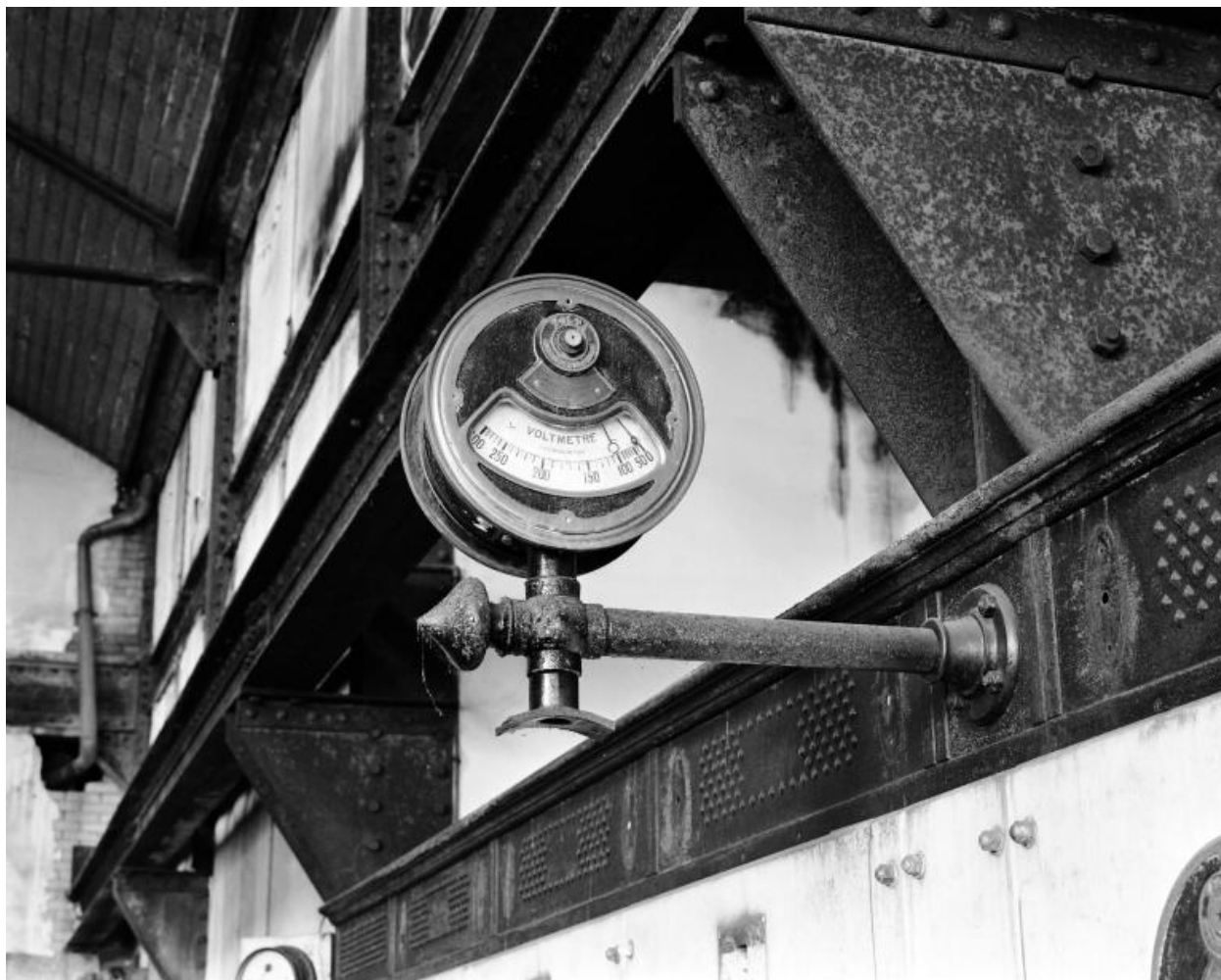
Nouvelle usine. Centrale électrique. Voltmètre Volta.
