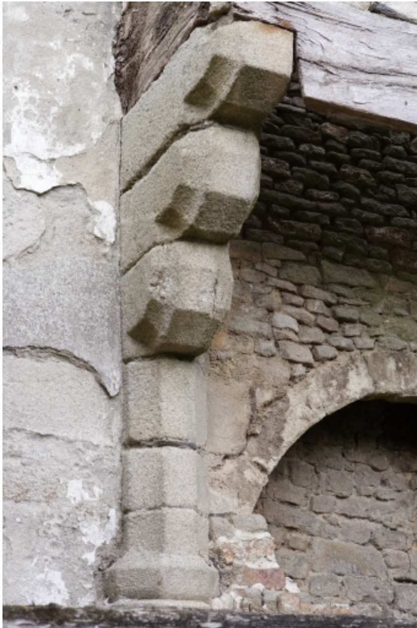
Logis. Aile sud. 1er étage. Salle haute. Détail du piédroit de gauche de la cheminée de la salle haute.
