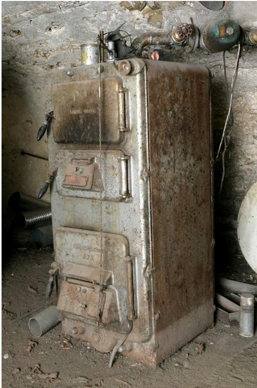
Le pavillon, sous-sol, chaudière, 2007.
