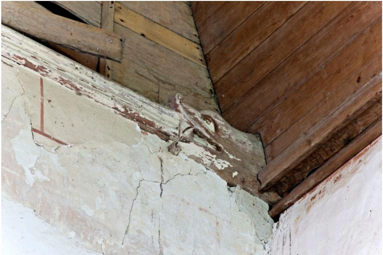
Détail de l'engoulant droit de la poutre.
