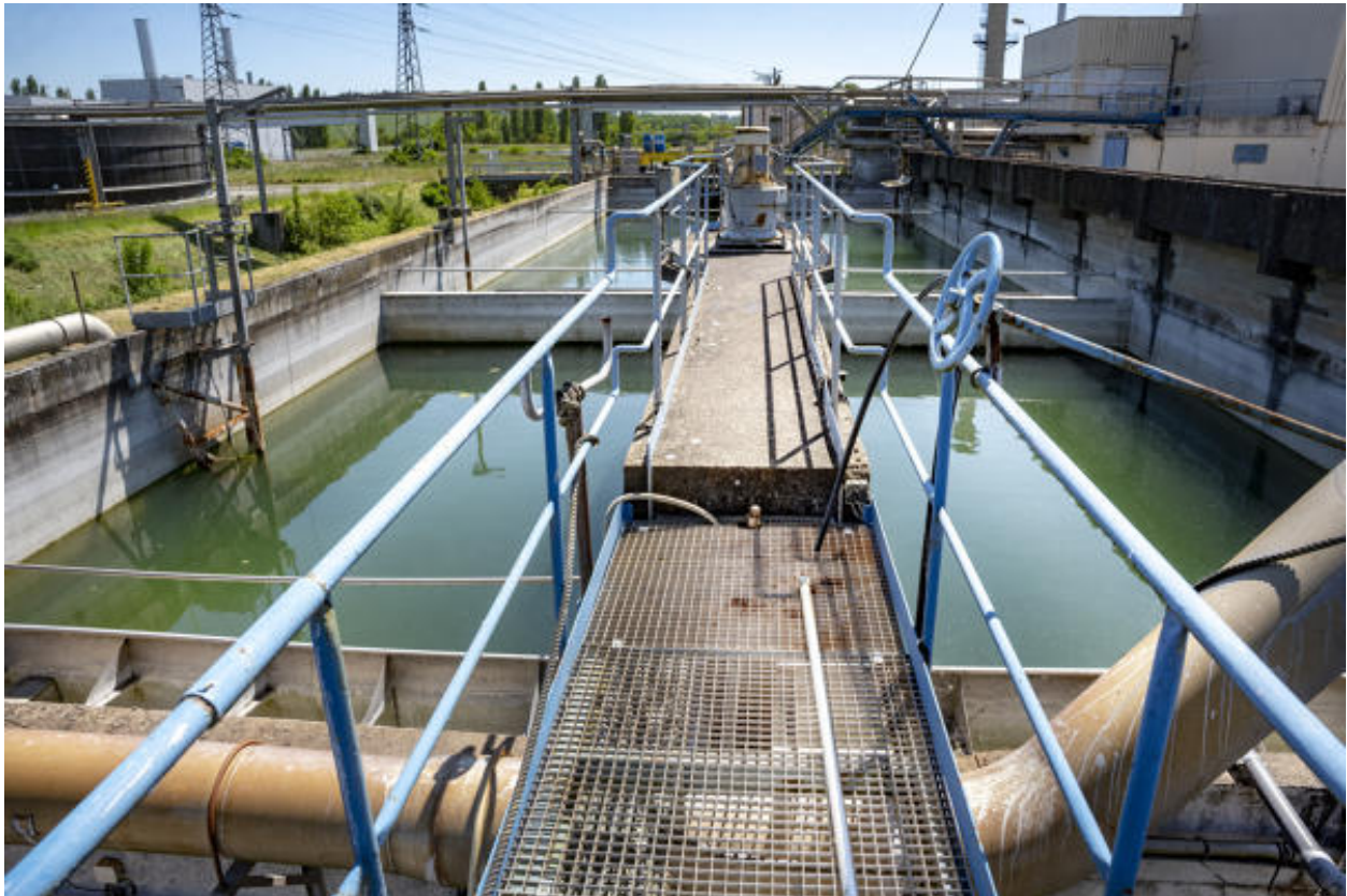
Station d'épuration Q de l'usine de papeterie.
