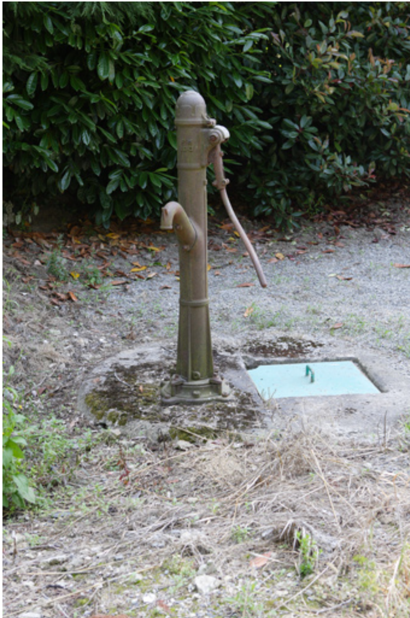
Pompe de puits commun.
