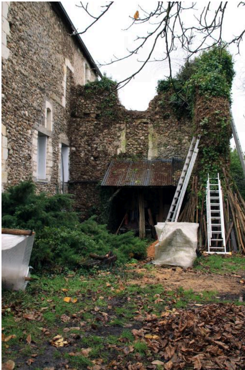
Le logis, façade postérieure : aile accolée en ruine.
