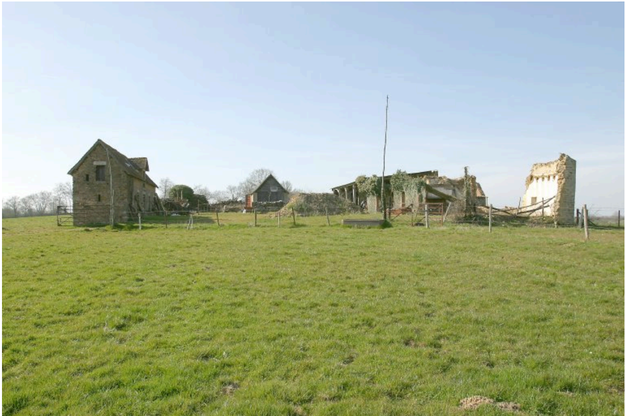
Vue d'ensemble depuis l'est. A droite, le logis-étable, ruiné ; à gauche, la porcherie ; au fond, la remise.
