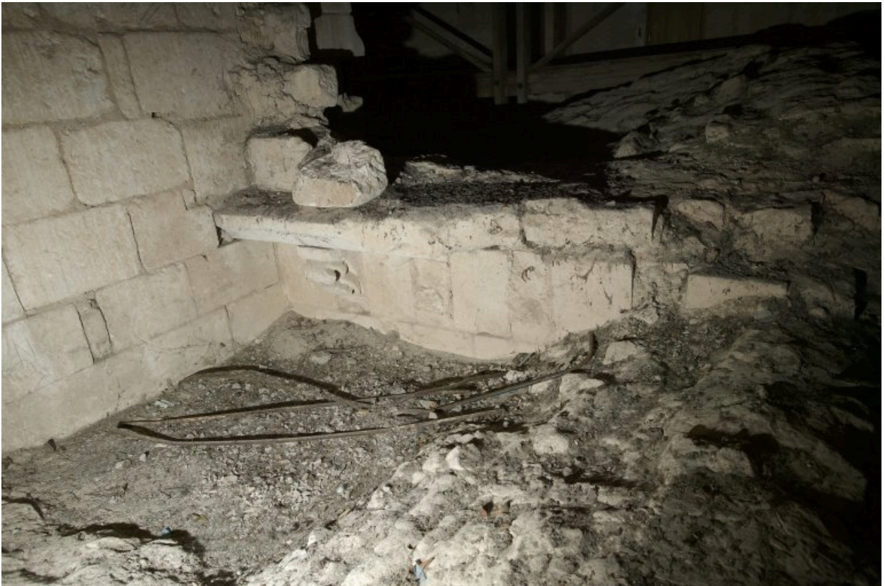
Parties hautes de la façade romane du bas-côté nord : vue extérieure de la troisième travée, prise des voûtes de la chapelle.
