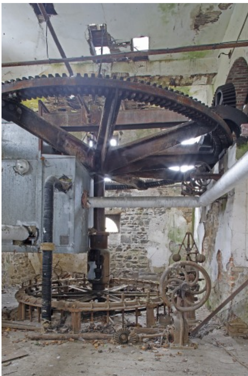
Le moulin à farine, rez-de-chaussée. La pièce est vue depuis le nord : les roues et le pignon de transmission de la force motrice et le régulateur de vitesse de la turbine.
