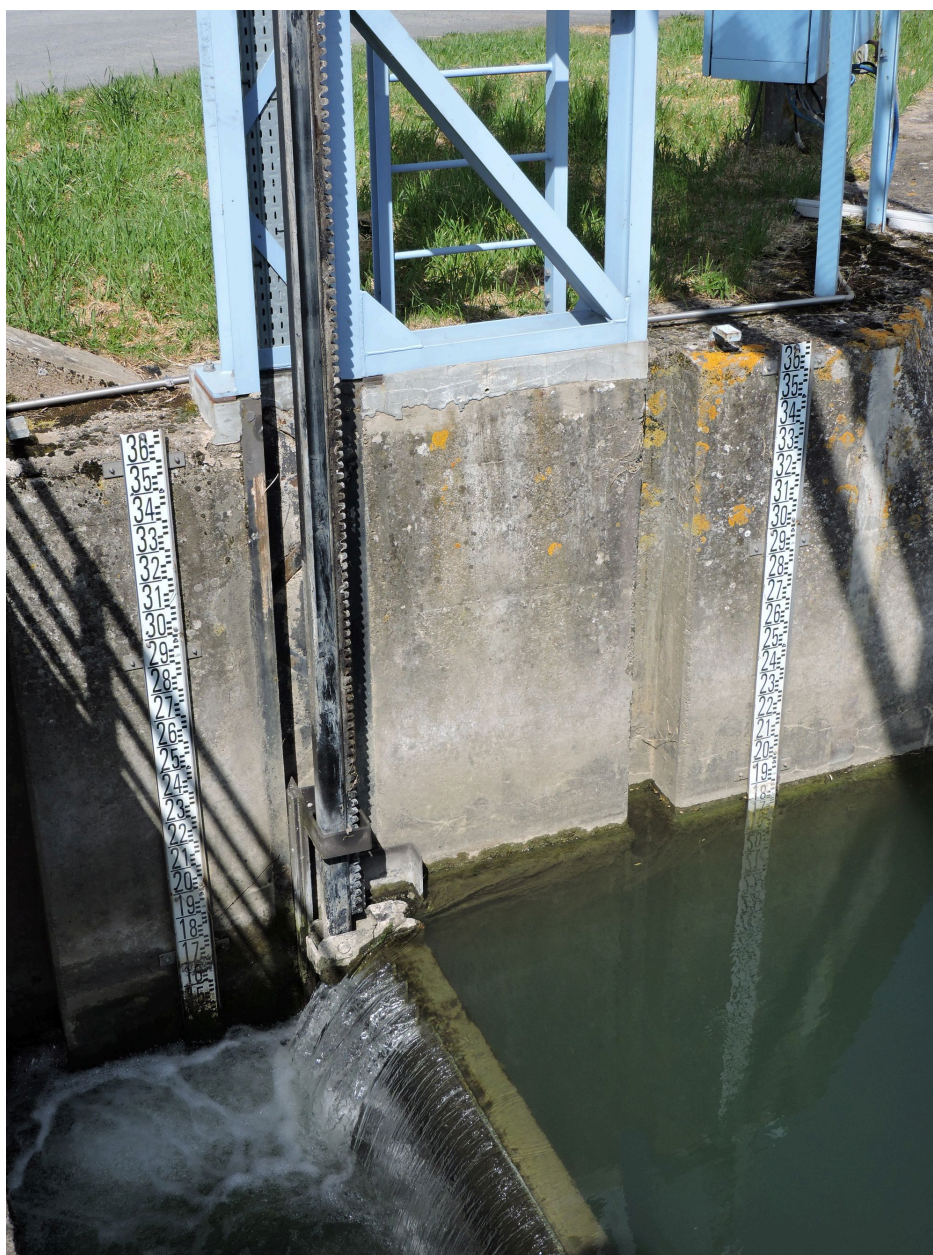
Vanne de fond avec crémaillère et règles de niveau d'eau en amont et en aval.
