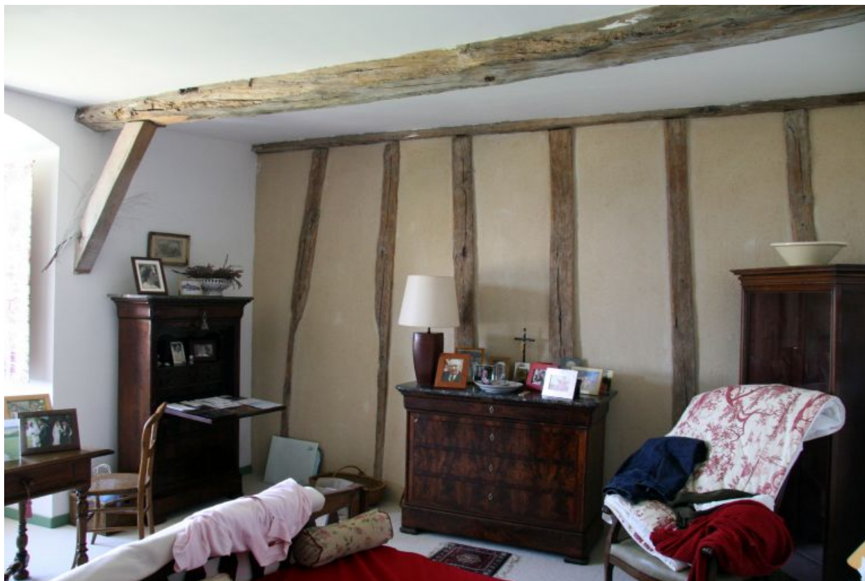
Le logis, façade postérieure en pan-de-bois : détail au 1er étage.
