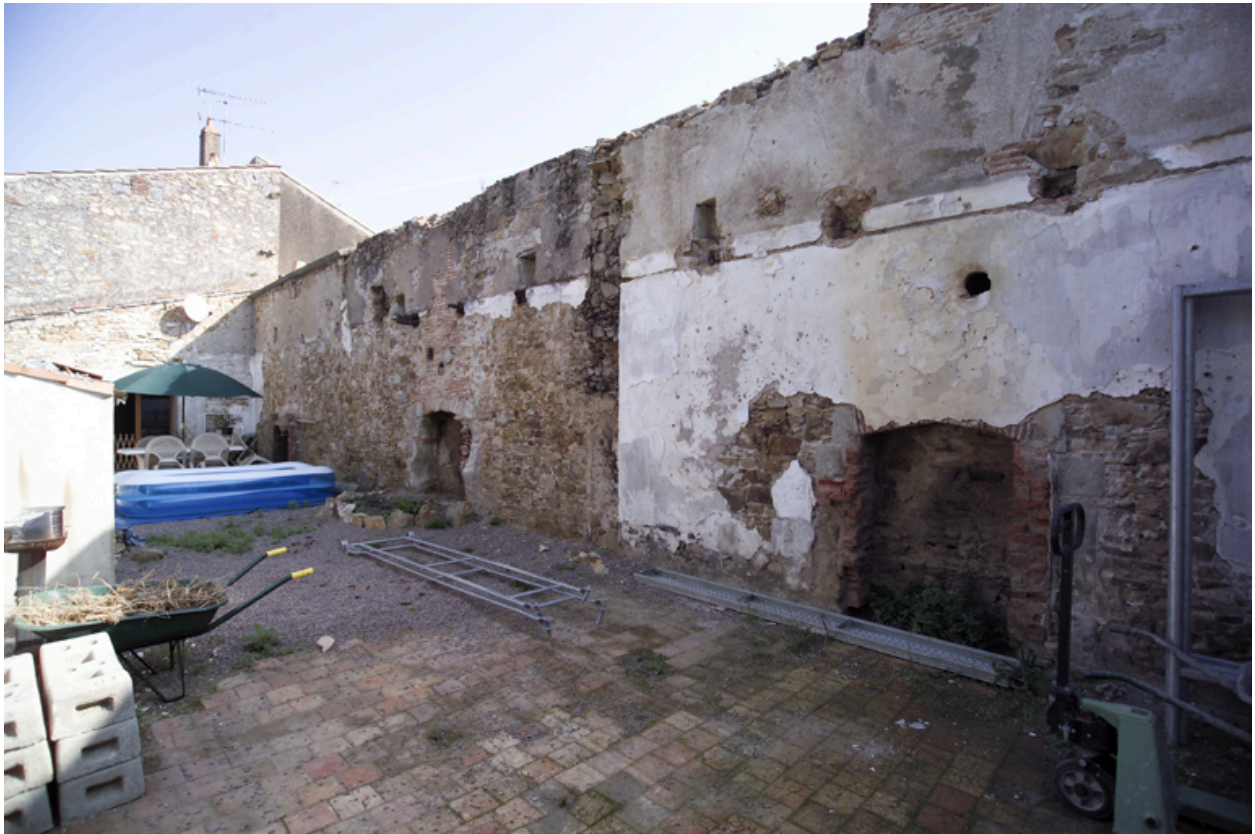
Vue des trois pièces détruites situées au sud du corps secondaire.
