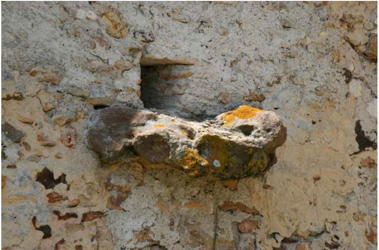
Façade postérieure : écoulement de l'évier.
