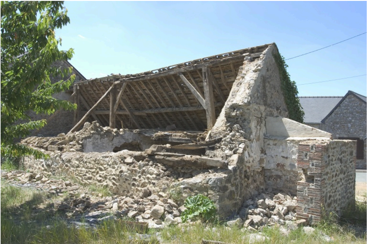
La façade arrière et le pignon nord avec la masse du four à pain.
