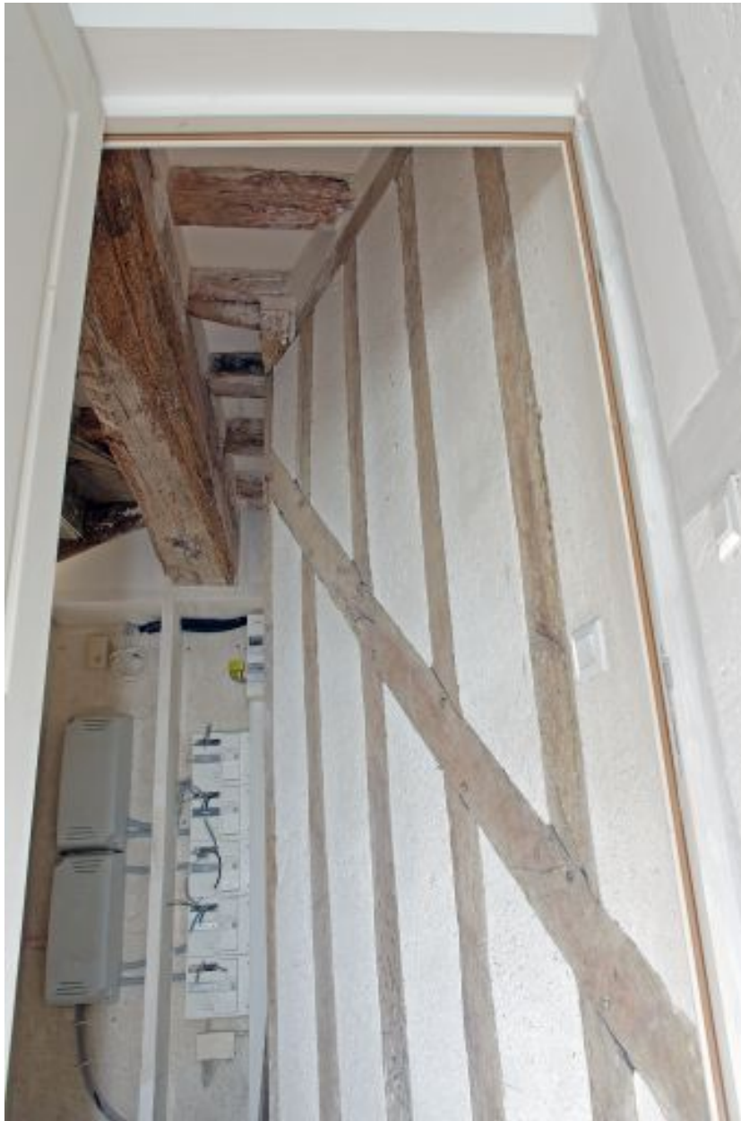
Cage d'escalier, 1er étage : cloison en pan de bois en partie biaise, entre l'escalier et la pièce antérieure, vue à travers la porte qui dessert la pièce postérieure.
