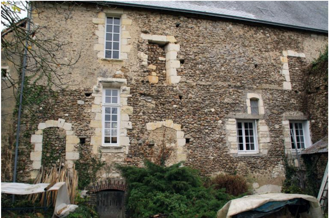
Le logis, façade postérieure : demie travée de gauche et accès à l'aile en ruine.
