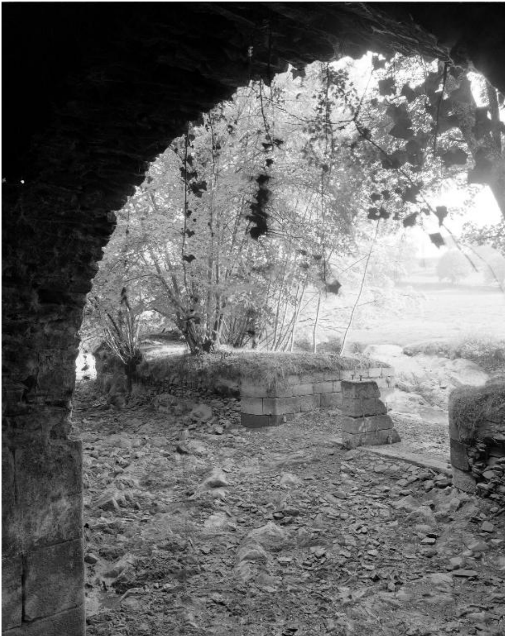
Vannes de décharge.
