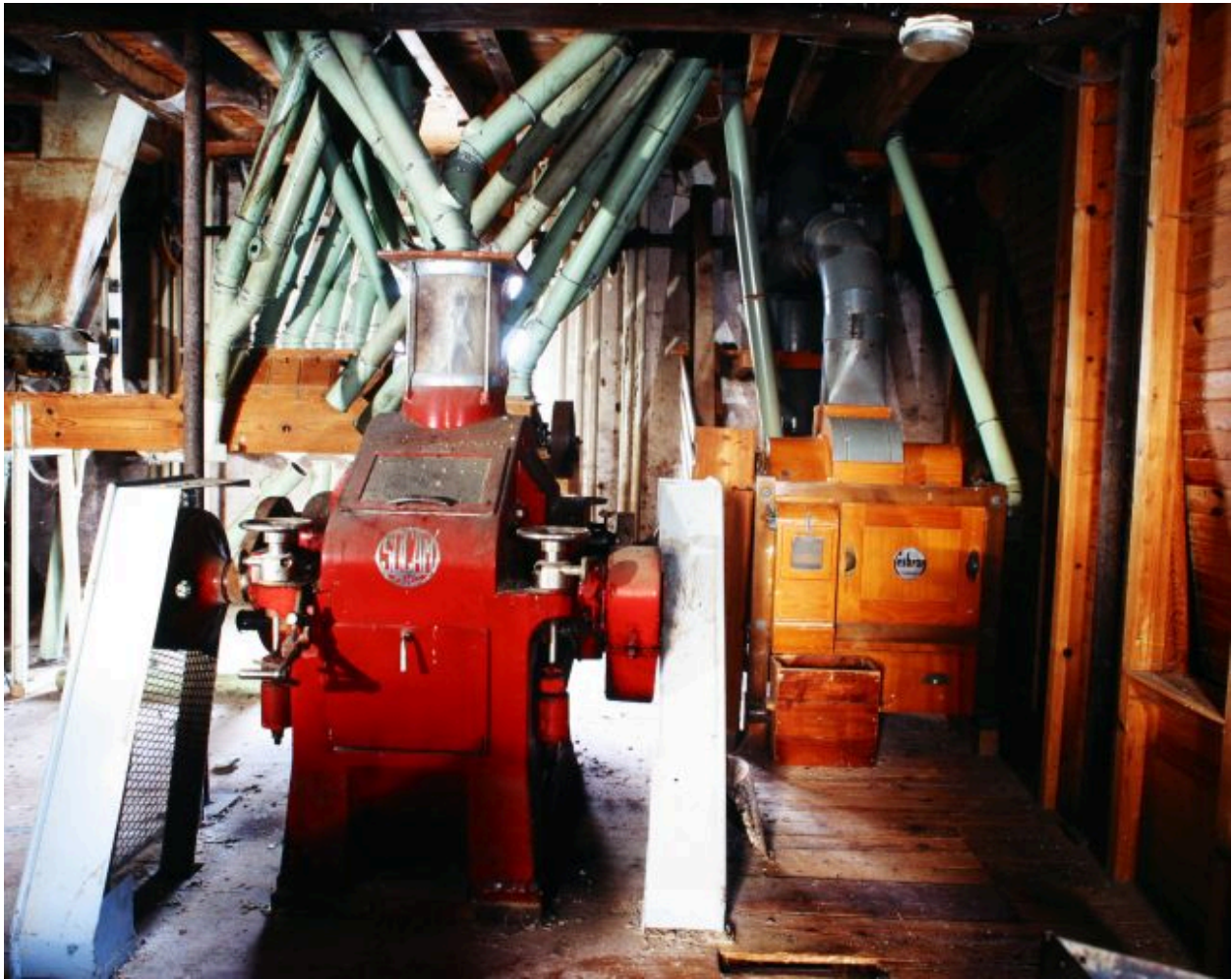
Deuxième étage, partie nord-est vue depuis le sud en 2002 : broyeur à cylindres de la marque SOCAM et brosse à blé de la marque Cesbron.
