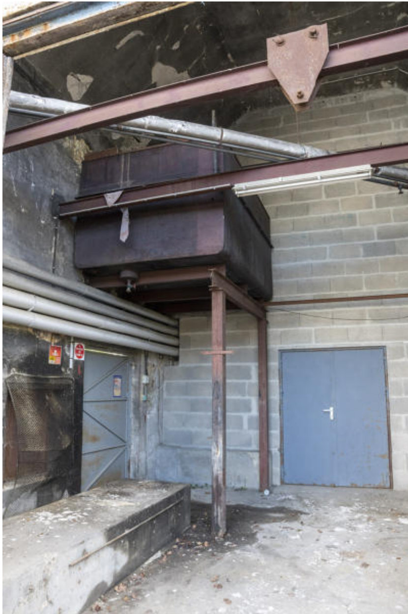
Vue intérieure de la chaufferie.
