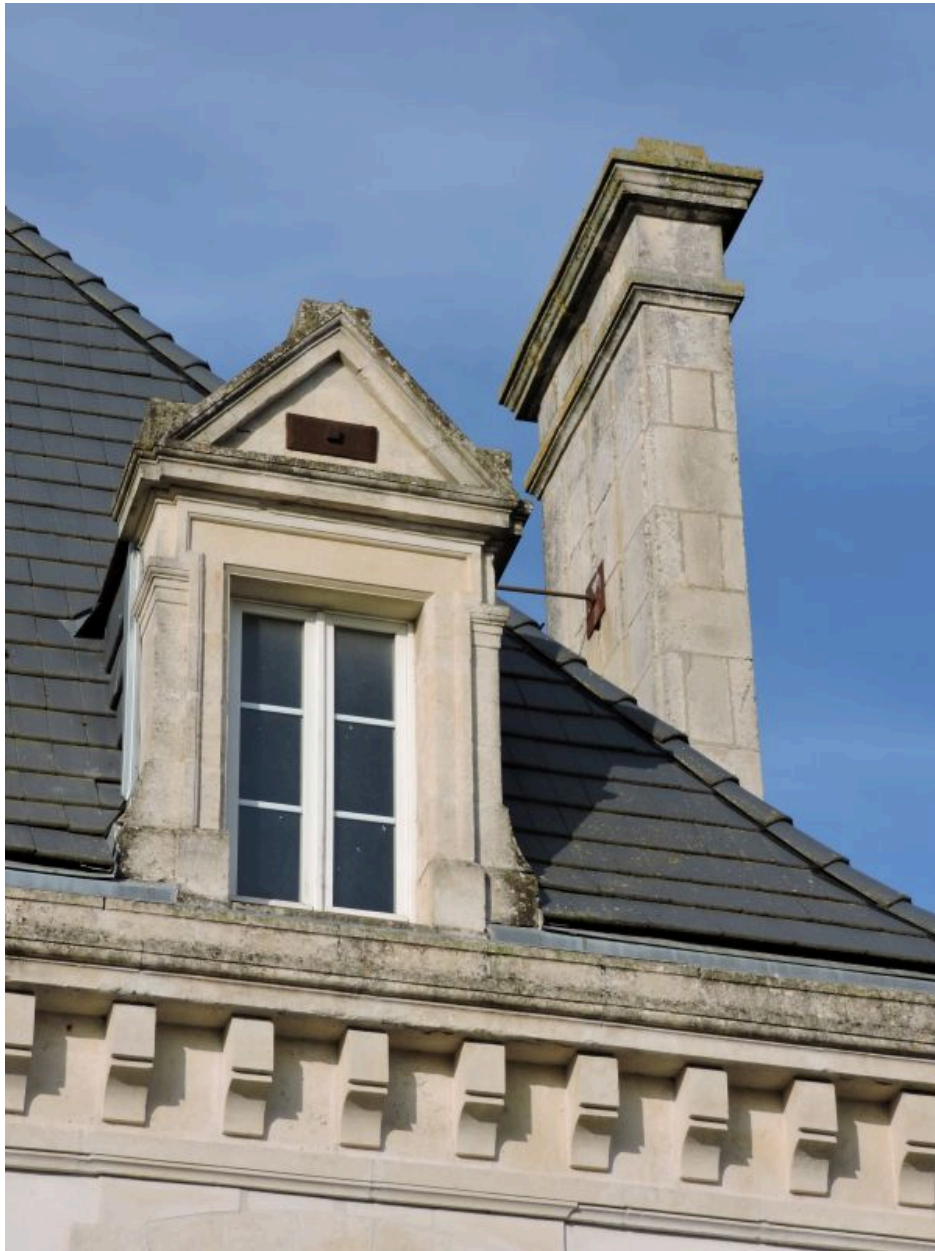
Détail de l'ancien logement de l'école de filles : souche de cheminée, lucarne, corniche à modillons.
