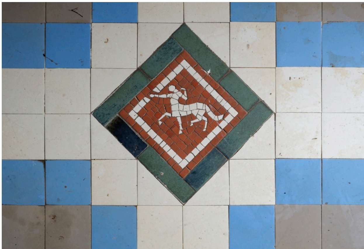
Corps ouest, intérieur, rez-de-chaussée : salle de réception, détail du carrelage des années 1930, à figures zodiacales, ici le sagittaire.
