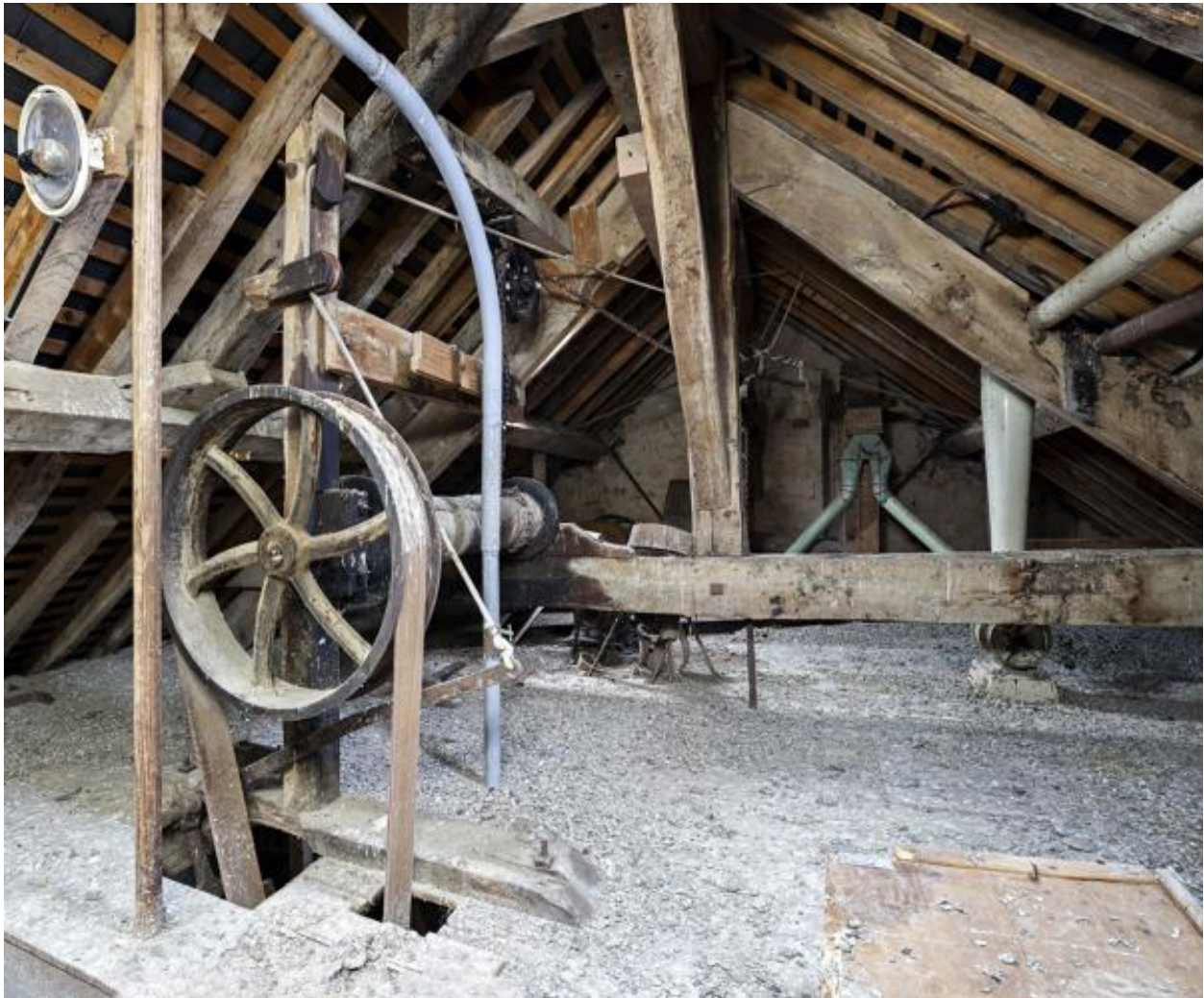
Comble, partie sud vue depuis le nord : le monte-sac.
