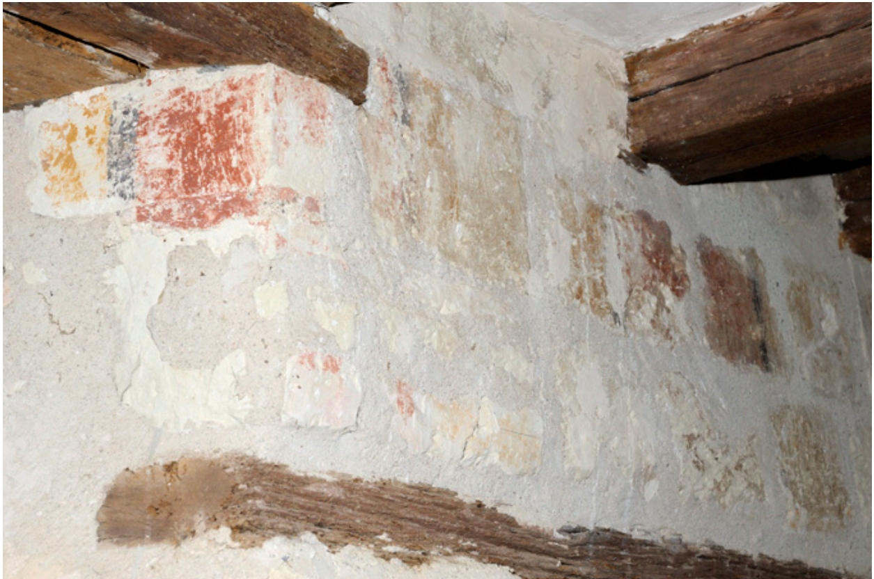
Corps principal, rez-de-chaussée, salle nord, pignon nord : peintures murales en partie haute du mur et du tableau de la porte sur rue.
