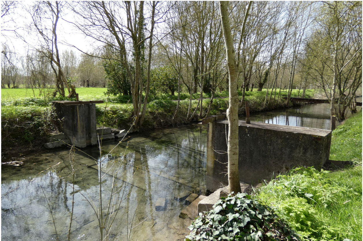
Le barrage mobile à la jonction entre le port et la rigole d'Aziré, côté amont.
