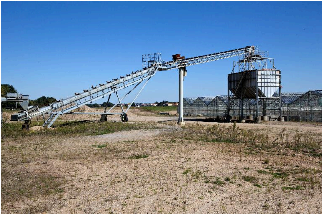
Silo de stockage pour le transport par camions.
